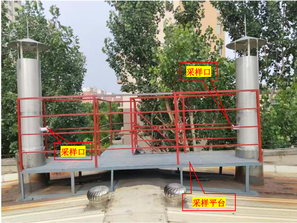
图 4-1 文荟园供热站排气筒
