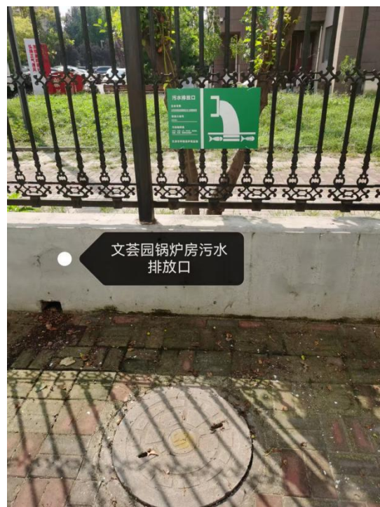
废水排放口 (DW001)
